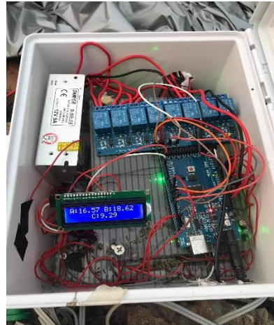
ภาพประกอบที่ 4 กล่องระบบควบคุมความชื้นแบบอัตโนมัติ
